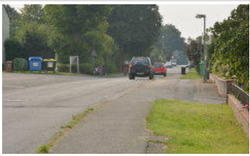
Im Osten des Silgen Bahren gibt es Laternen und Reste von Fußwegen. Darum zahlen die Anwohner nur die Hälfte der Sanierungskosten. ©
